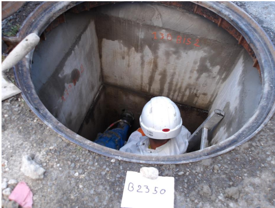
Bâche de transfert – Rue du Sudre
