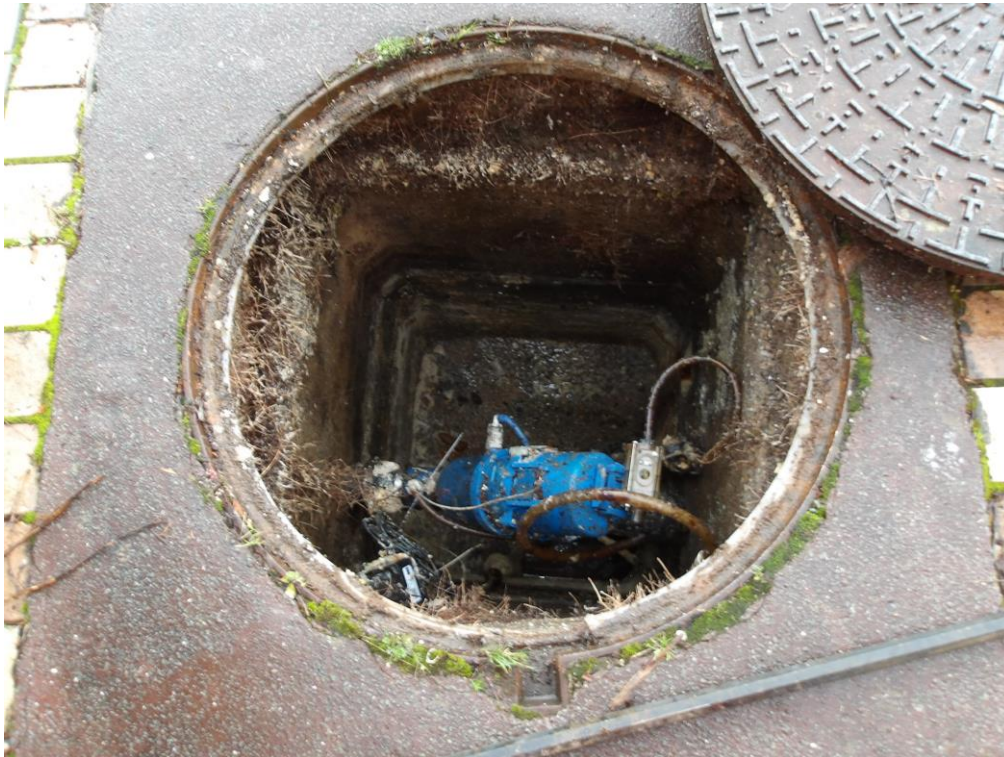
Bâche de transfert – Avenue de Libourne
